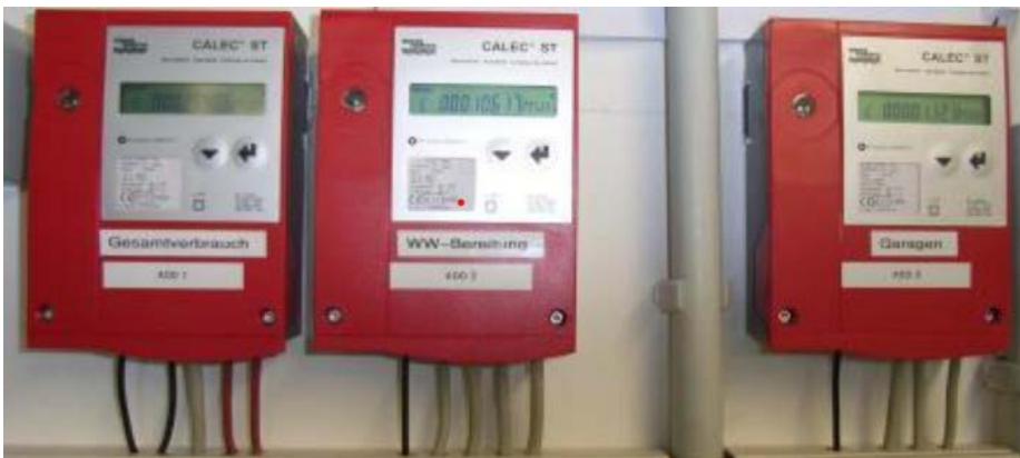
Foto: busfähige, vernetzte Wärmemengenzähler in einer Polizeidienststelle
